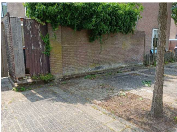
Knelpunt: verzakt maaiveld t.o.v. fundering woningen
